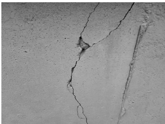
Рис. 6. Изображение с видимой трещиной
